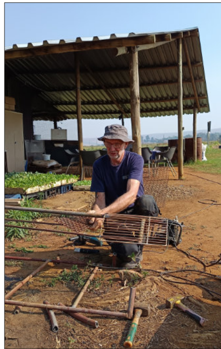
Treppe und Filter für ein Regenwasserbecken in Newcastle
