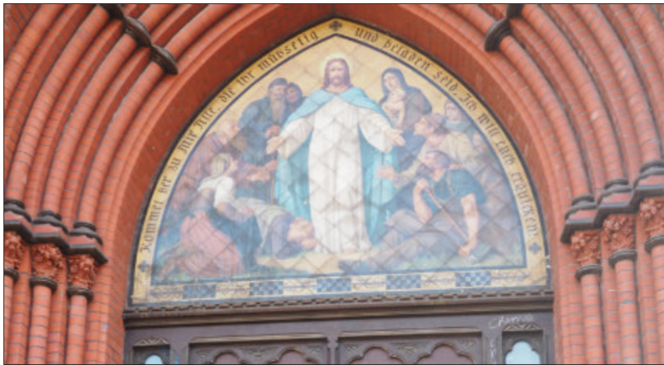
Das Bild im Portal der Lukaskirche, das durch Farbe beschädigt wurde
