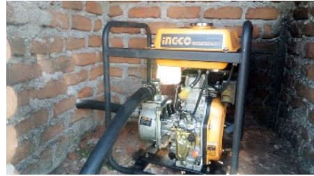
Ein kräftiger Motor pumpt das Wasser aus dem Fluss.
