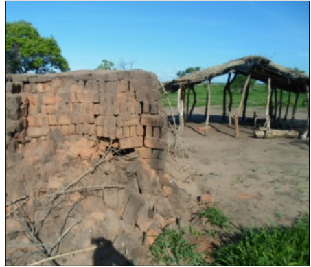
Hier liegt schon fast alles bereit für einen festen Kirchbau, aber es fehlt noch an Geld für Zement, Balken und Dachbleche.
